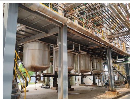
建业资源废水预处理
