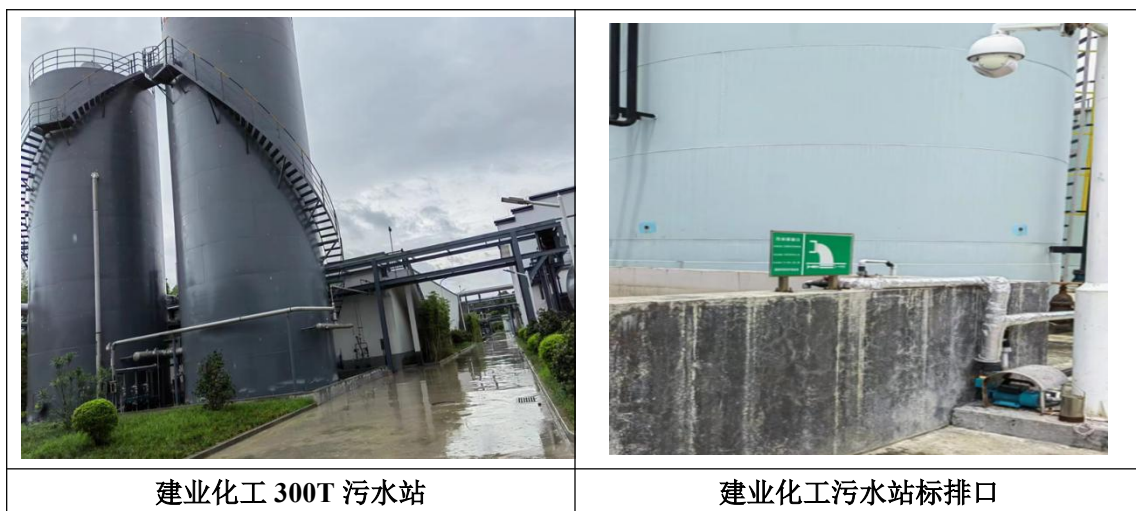
图 4.1-6 废水治理设施图片
