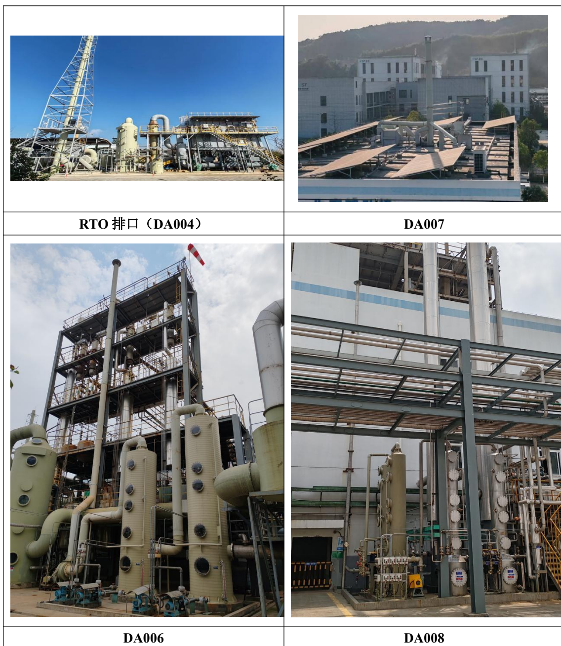
图 4.1-9 废气治理设施图片
